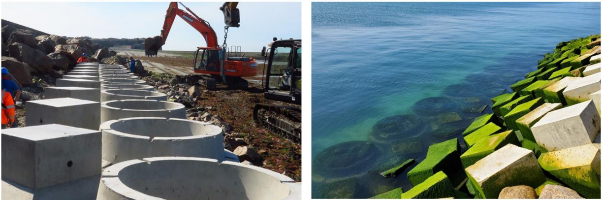
Figure 3. Mise en place du bloc de pied ACCROBERM™ II : pose de la butée mai 2021 (gauche), état de la butée en septembre 2021 (droite)
