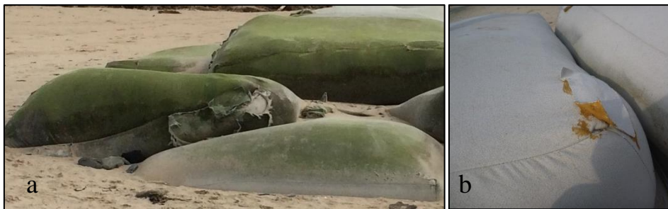
Photo 6 : usure prématurée des matériaux constituant l'enveloppe externe des géocontainers de l'épi de Saint-Jean-le-Thomas (a) ; décollement de pièces fermant les bouches de remplissage des géocontainers (b).
